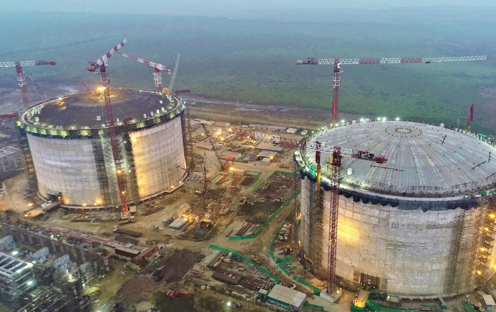
LNG Tanks for Adani's Dhamra LNG Terminal Pvt. Ltd.
